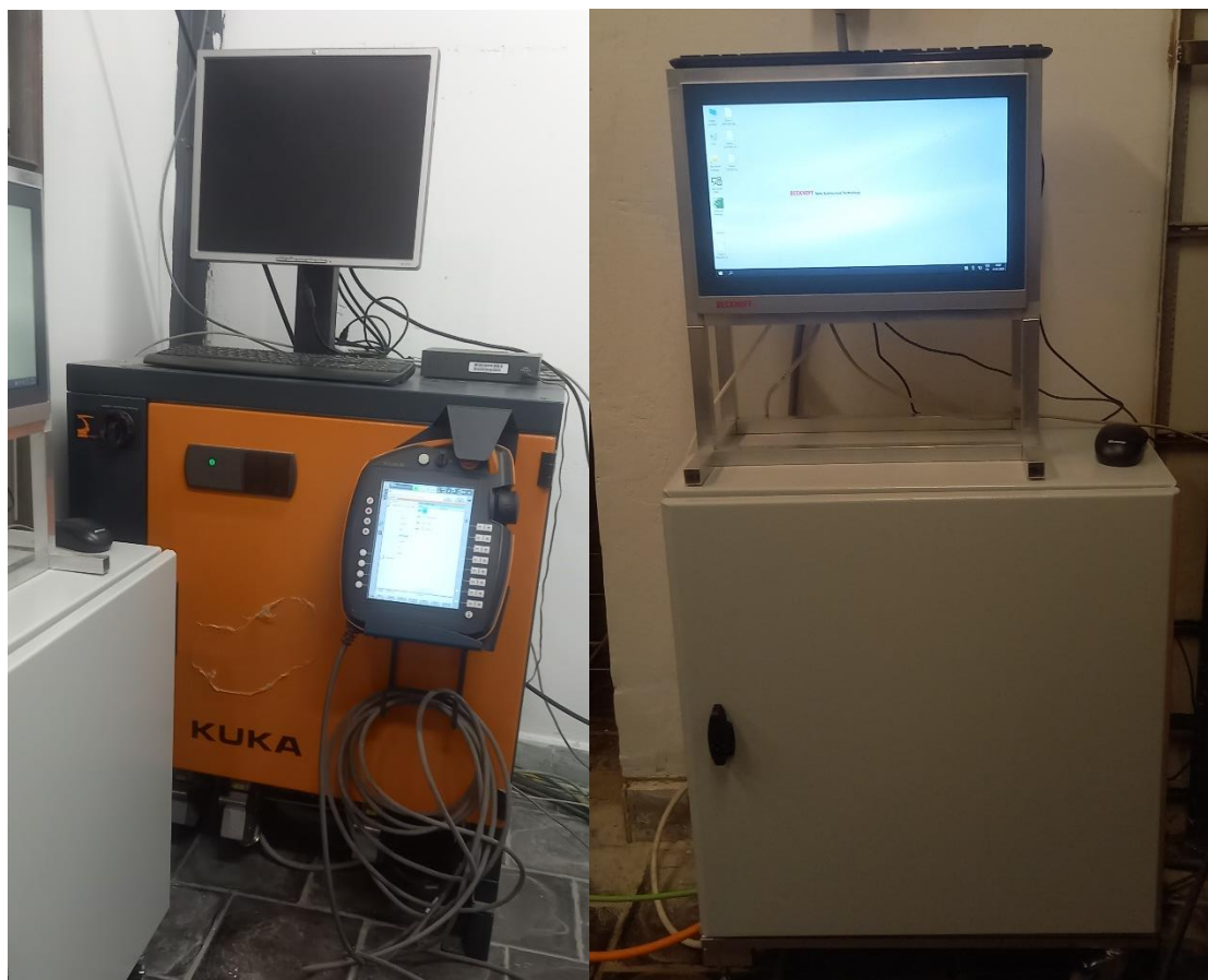
Obr. 4. Kontrolér KR C4 (vlevo), HMI a PLC (vpravo)
